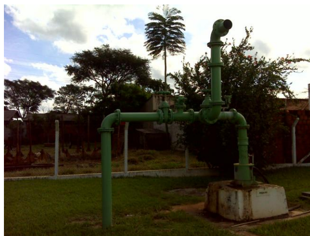
FOTO 5.2 – POÇO PROFUNDO P5
