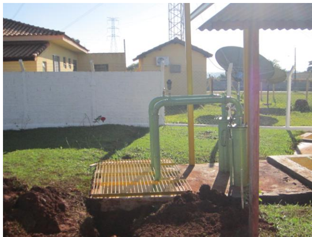
FOTO 5.9 – BOOSTER ZONA ALTA.
