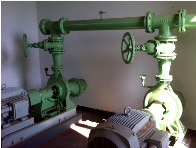
FOTO 5.7 – VISTA DAS BOMBAS DA EEAT 1
