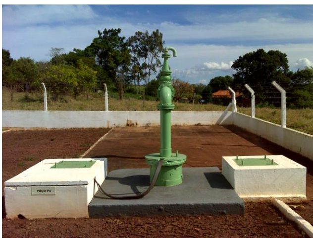
FOTO 5.1 – POÇO PROFUNDO P4
