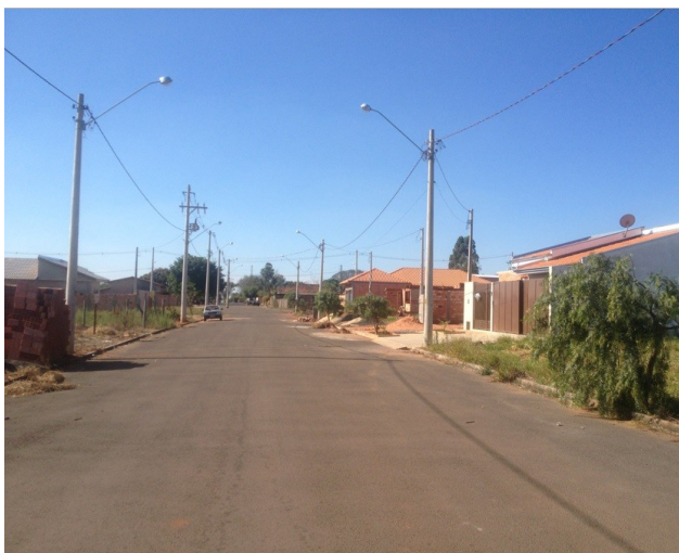
Figura 1— Vista da Av. Guilherme de Arruda Castanho com o transformador de energia ao fundo (lado direito)
