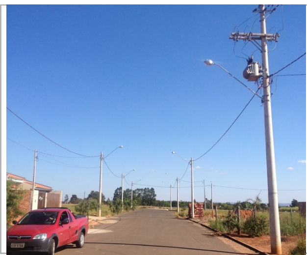
Figura 3— Vista do transformador de energia na Av. Guilherme de Arruda Castanho
