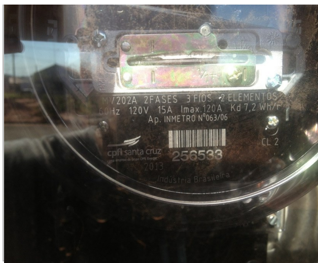
Figura 11—Aproximação do leitor de energia elétrica
