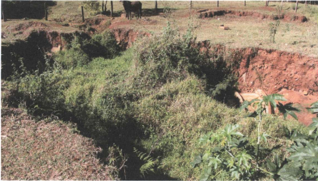
Figura 16: Formação de ravinas ao longo da tubulação de drenagem de águas pluviais.
